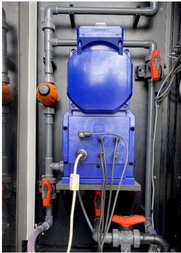
Ein Durchflussmesser registriert die jährliche Gülleproduktion und den genauen Schwefelsäureverbrauch pro m 3 Gülle
